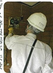
プレーカー点検中
